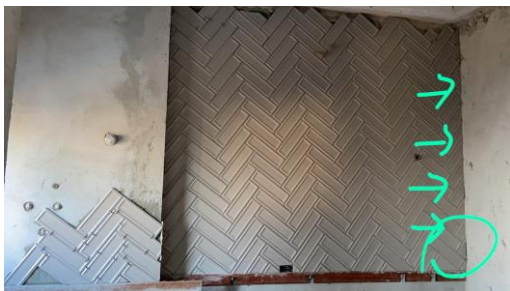
Imagem 04: azulejos instalados incorretamente.
